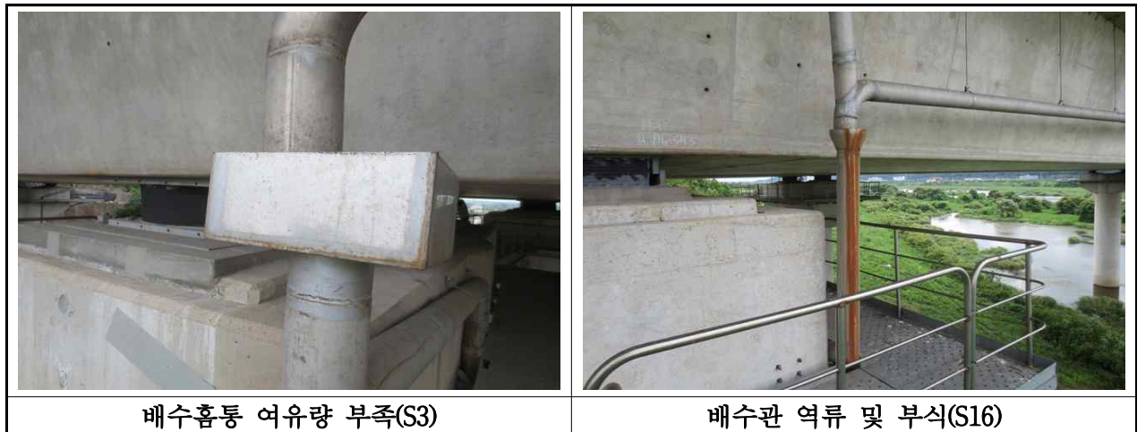
【사진 3.3.18】 배수시설 손상현황(부산)
