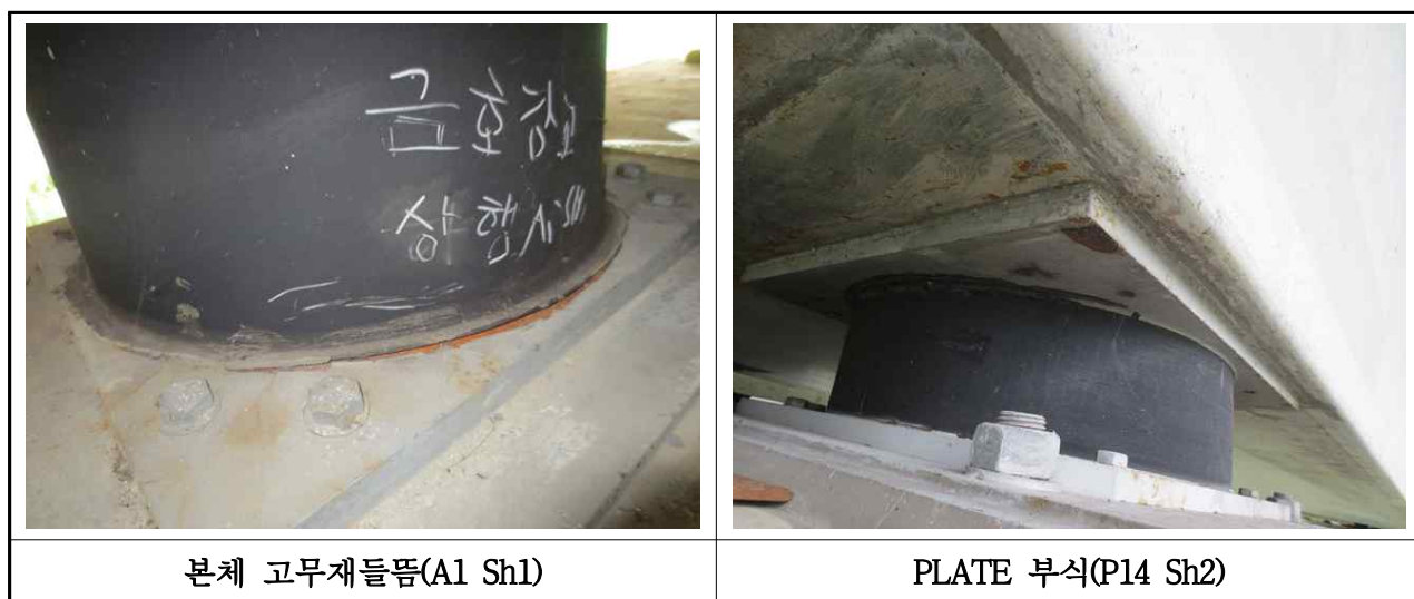
【사진 3.2.11】교량받침 손상현황(대구)
