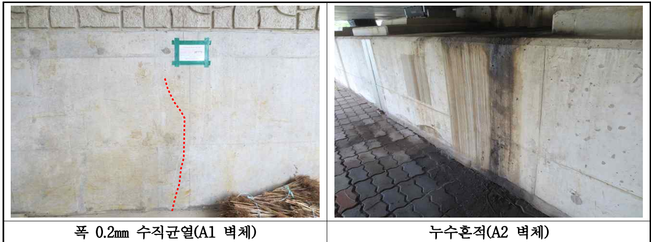
【사진 3.3.6】교대 손상현황(부산)
