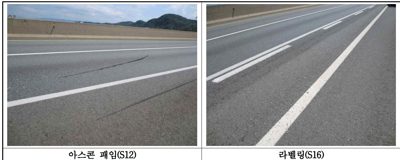
【사진 3.3.16】 교면포장 손상현황(부산)
