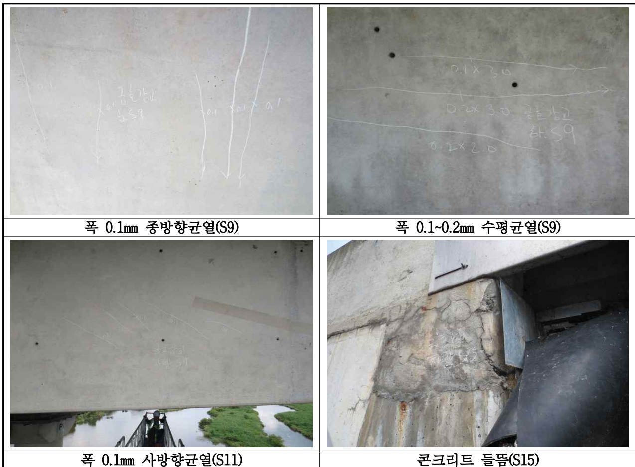
【사진 3.3.2】 거더 외부 손상현황(부산)
