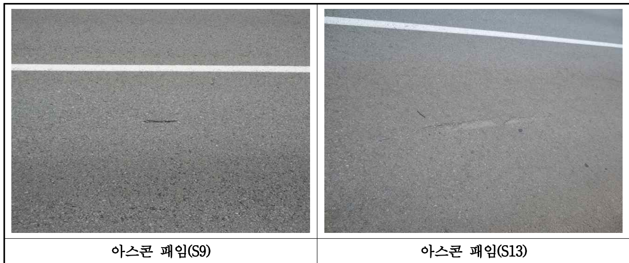
【사진 3.2.16】 교면포장 손상현황(대구)
