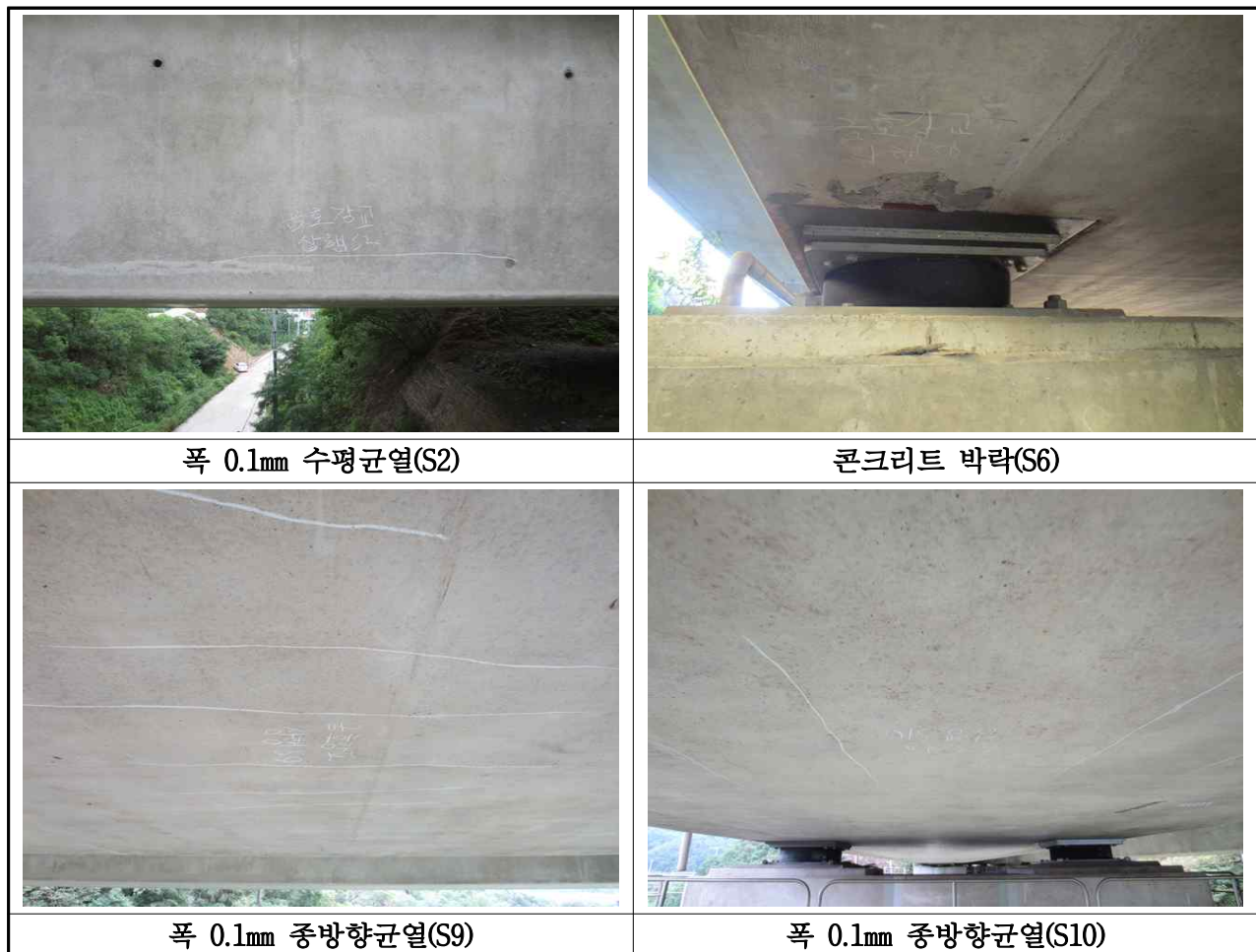
【사진 3.2.2】 거더 외부 손상현황(대구)
