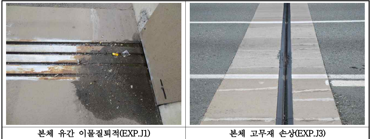
【사진 3.3.13】 신축이음장치 손상현황(부산)
